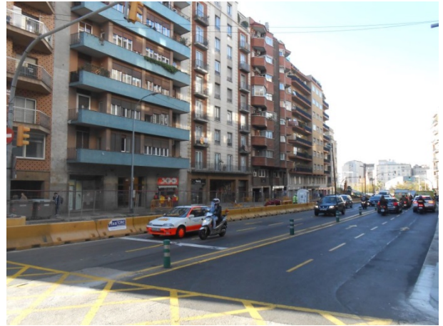
FOTO 02. Situació inicial a 18 de novembre de 2016. Tram 1
