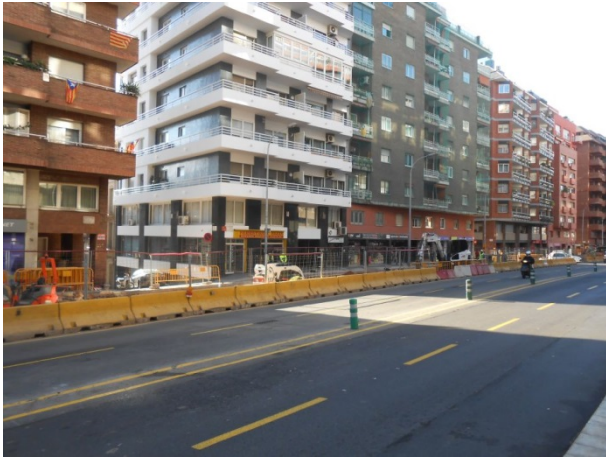
FOTO 07. Situació inicial a 18 de novembre de 2016. Tram 5
