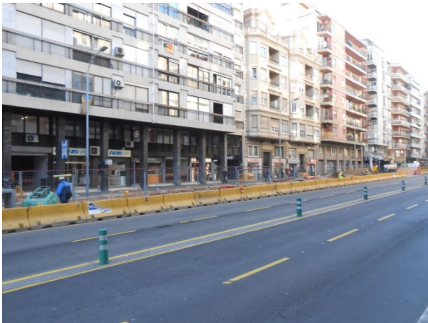
FOTO 03. Situació inicial a 18 de novembre de 2016. Tram 2
