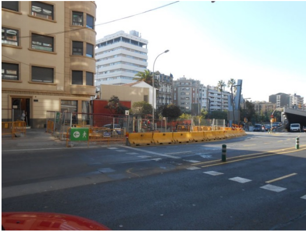
FOTO 01. Situació inicial a 18 de novembre de 2016. Tram 1.
