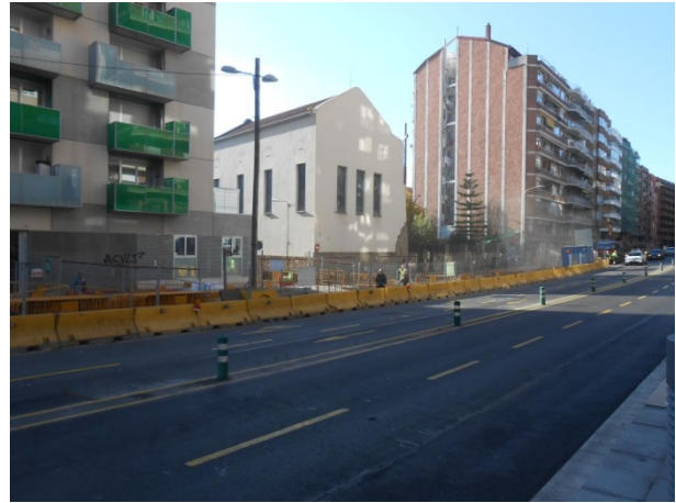
FOTO 08. Situació inicial a 18 de novembre de 2016. Tram 6
