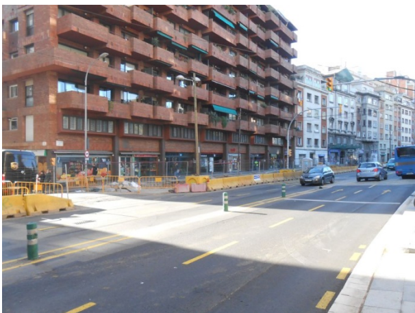
FOTO 05. Situació inicial a 18 de novembre de 2016. Tram 3
