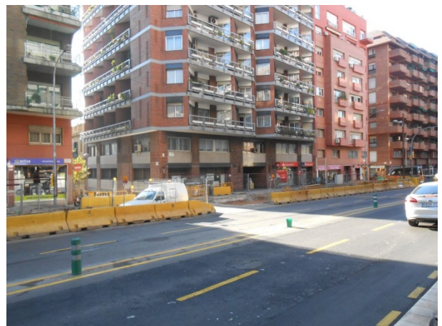
FOTO 06. Situació inicial a 18 de novembre de 2016. Tram 4
